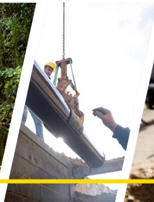
bestaande en nieuwe riolering
